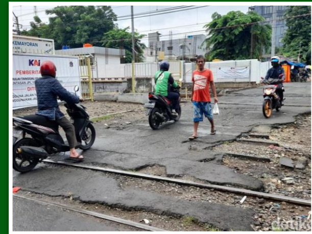
Perlindungan dengan kondisi aspal rusak
